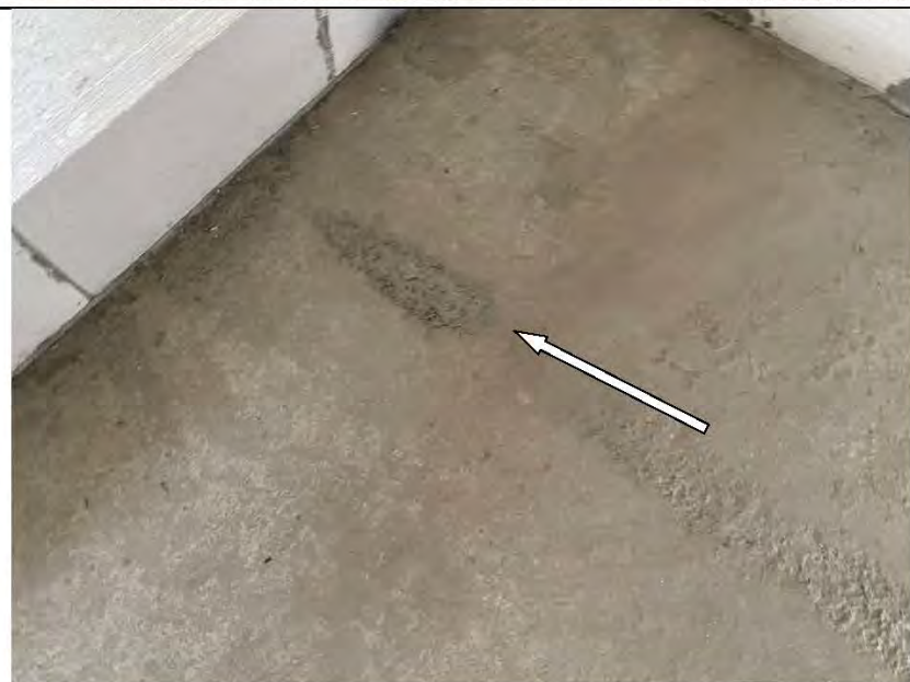
Фото №35. Железобетонные элементы конструкции имеют дефекты в ванной комнате.
