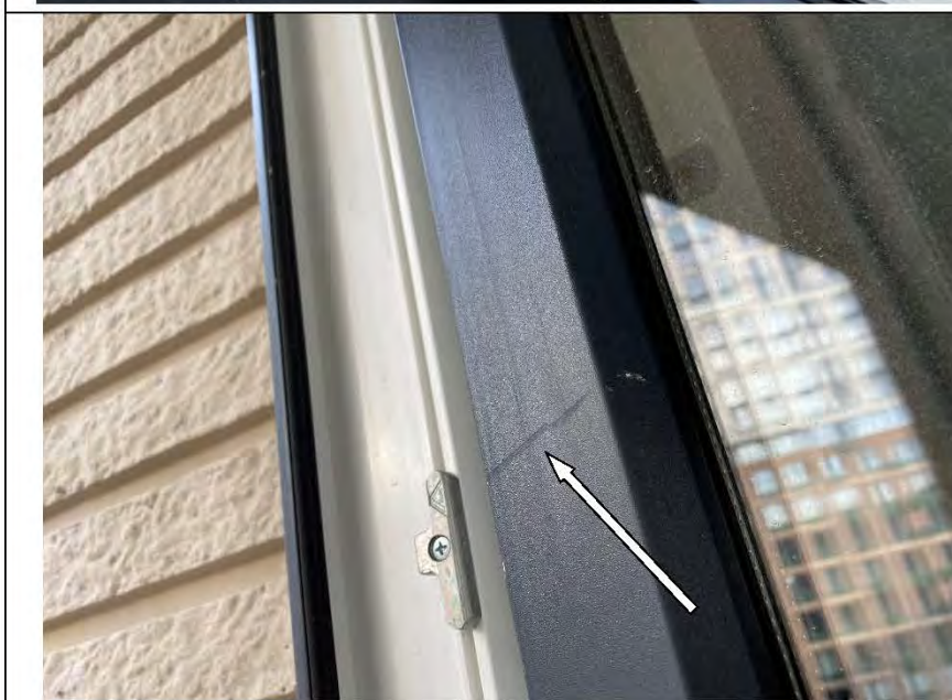
Фото №12. Профиль ПВХ оконного блока в гостиной имеет дефекты (царапины, загрязнения, сколы) .
