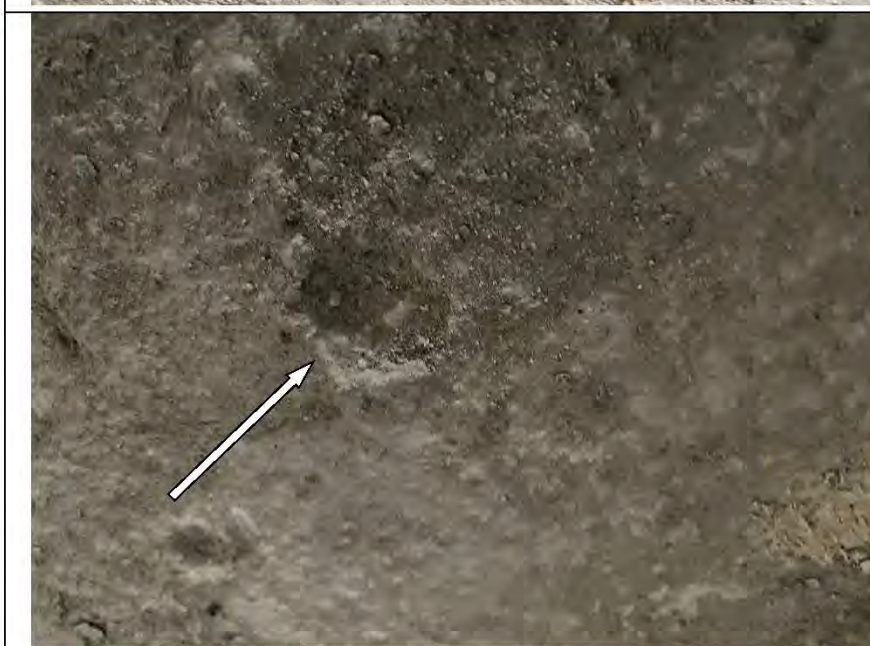
Фото №39. Железобетонные элементы конструкции имеют дефекты в спальне.
