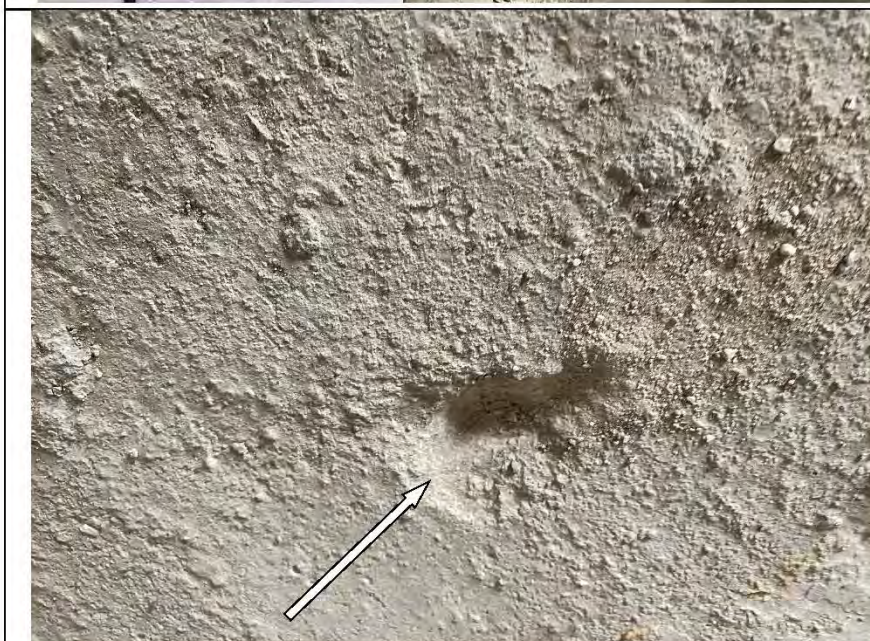
Фото №38. Железобетонные элементы конструкции имеют дефекты в спальне.
