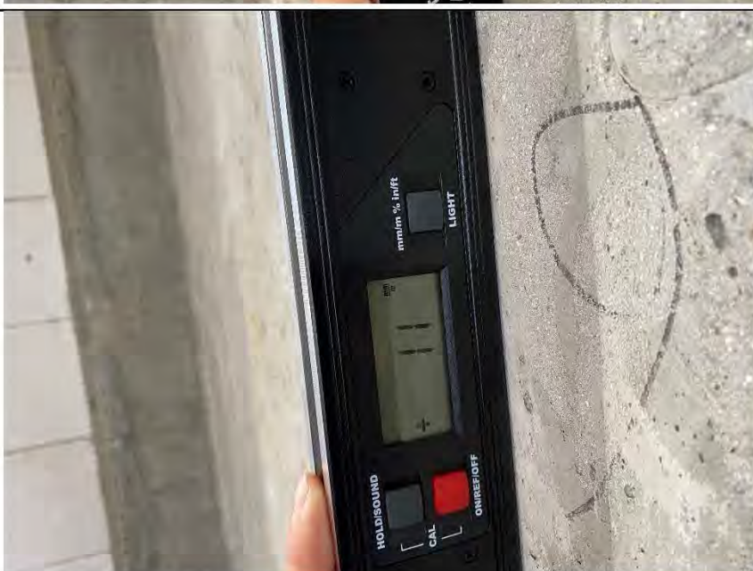
Фото №42. Измерение уровня ж/б стены в гостиной.
