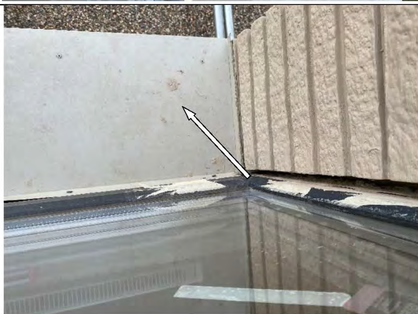
Фото №18. Металлический отлив оконного блока ПВХ в гостиной имеет дефект.
