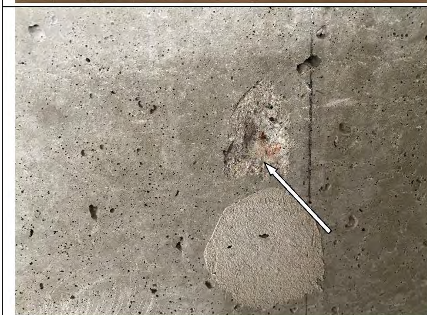
Фото №27. Железобетонные элементы конструкции имеют дефекты в гостиной.
