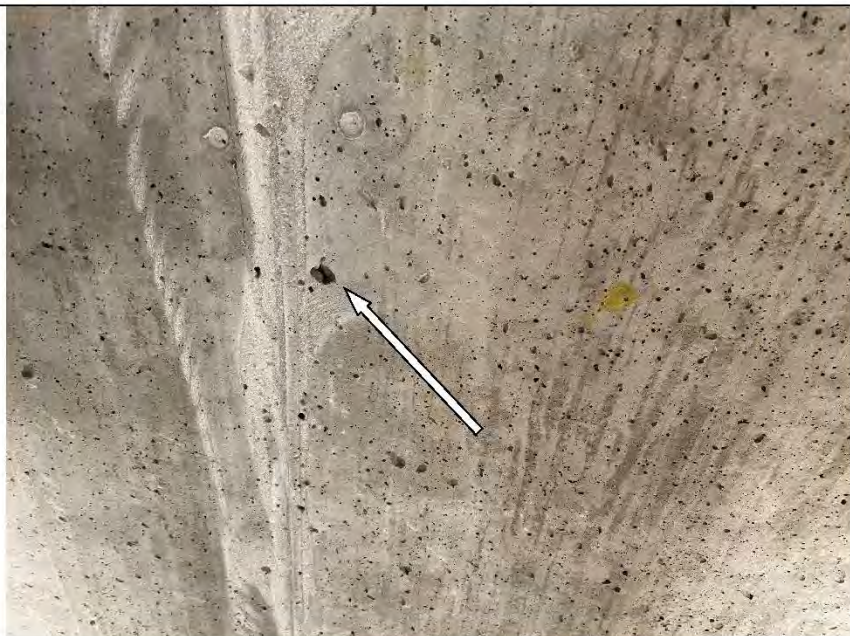
Фото №28. Железобетонные элементы конструкции имеют дефекты в спальне.
