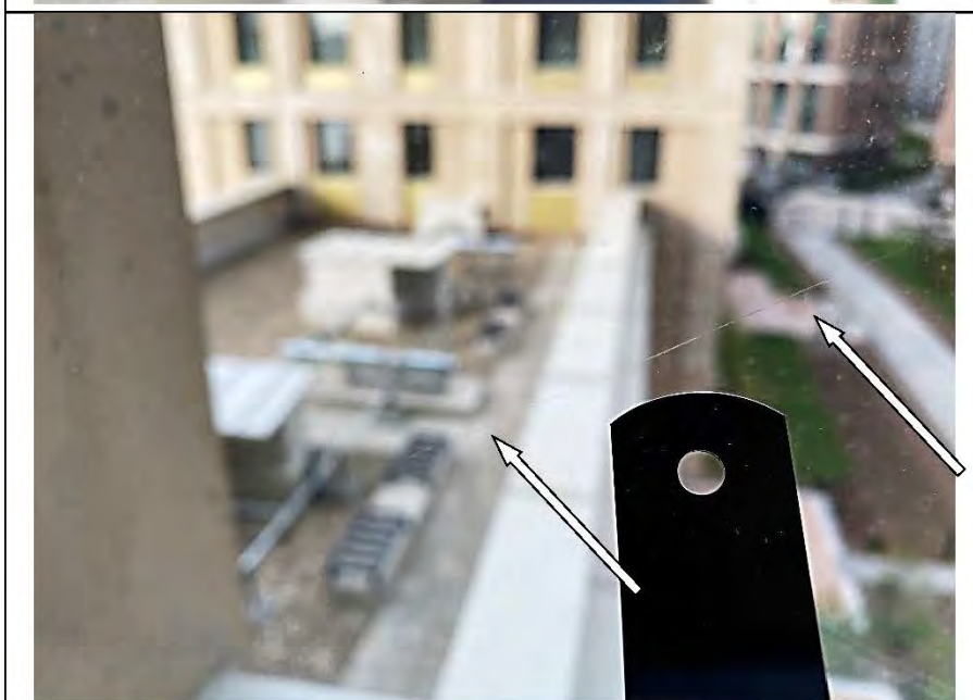
Фото №8. На стеклопакете оконного блока ПВХ имеется дефекты в гостиной.
