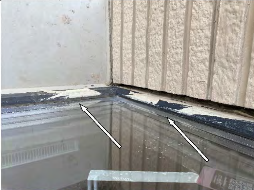
Фото №13. Профиль ПВХ оконного блока в гостиной имеет дефекты (царапины, загрязнения, сколы).
