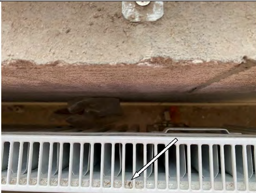
Фото №20. Радиатор в гостиной имеет дефекты (загрязнения).
