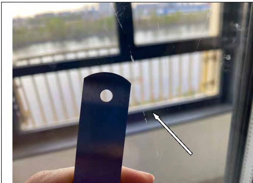
Фото №10. На стеклопакете оконного блока ПВХ имеется дефекты в спальне.
