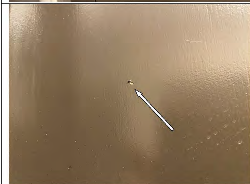
Фото №26. Дефекты (царапина) на доборном элементе входной дверного блока.
