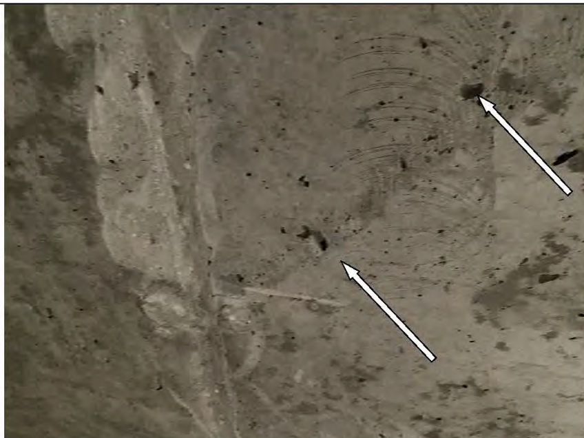
Фото №31. Железобетонные элементы конструкции имеют дефекты в гостиной.
