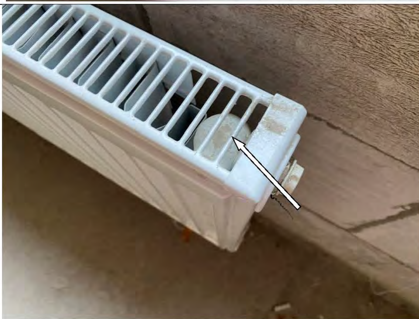
Фото №21. Радиатор в спальне имеет дефекты (загрязнения).
