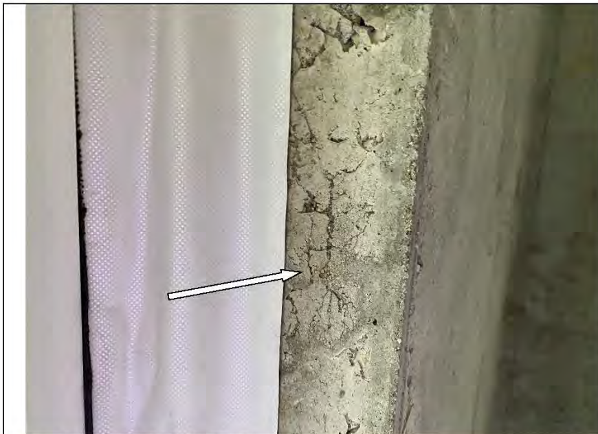
Фото №37. Железобетонные элементы конструкции имеют дефекты в спальне.
