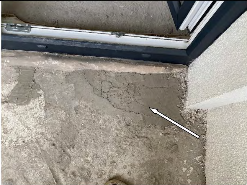
Фото №34. Железобетонные элементы конструкции имеют дефекты в лоджии.
