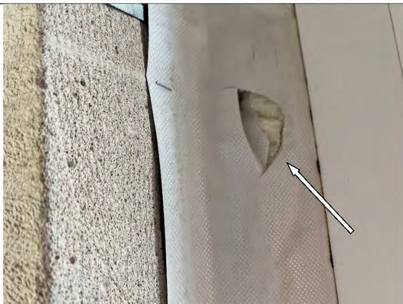
Фото №15. Монтажный шов оконных блоков ПВХ в гостиной выполнен с дефектом.
