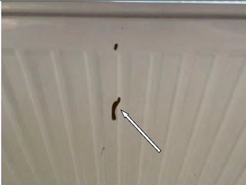
Фото №19. Радиатор в кухне имеет дефект (загрязнение).
