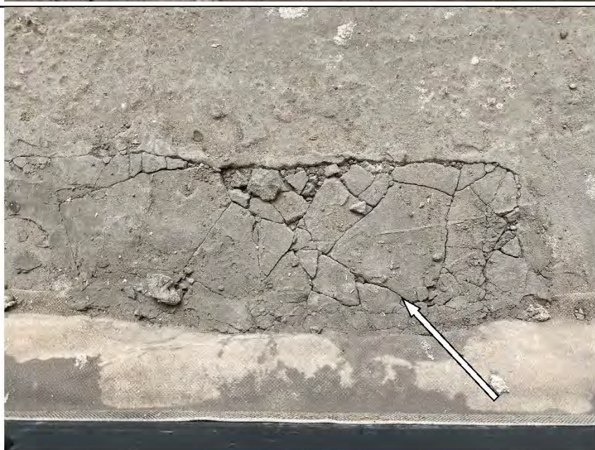
Фото №30. Железобетонные элементы конструкции имеют дефекты на лоджии.
