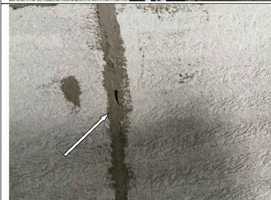
Фото №51. Дефект швов кладки стен в гостиной.
