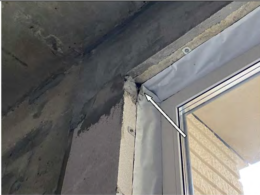
Фото №16. Монтажный шов оконных блоков ПВХ в гостиной выполнен с дефектом.
