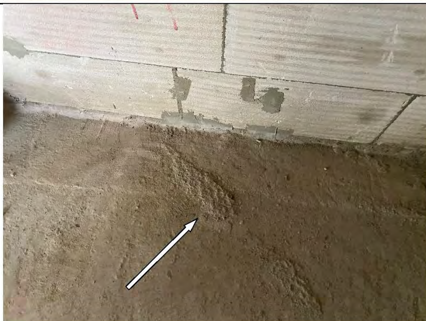
Фото №32. Железобетонные элементы конструкции имеют дефекты в ванной комнате.
