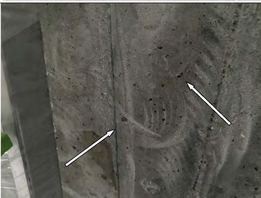
Фото №36. Железобетонные элементы конструкции имеют дефекты в гостиной.
