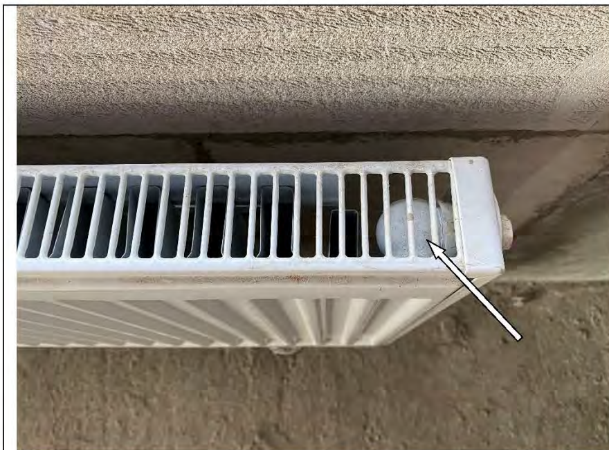
Фото №22. Радиатор в гостиной имеет дефекты (загрязнения).
