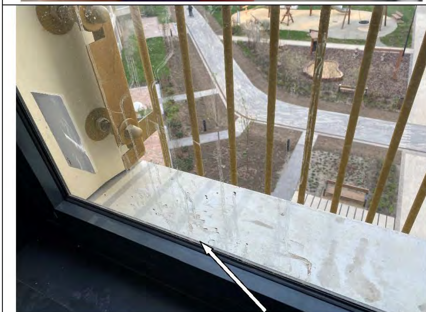
Фото №11. На стеклопакете оконного блока ПВХ имеется дефекты в лоджии.
