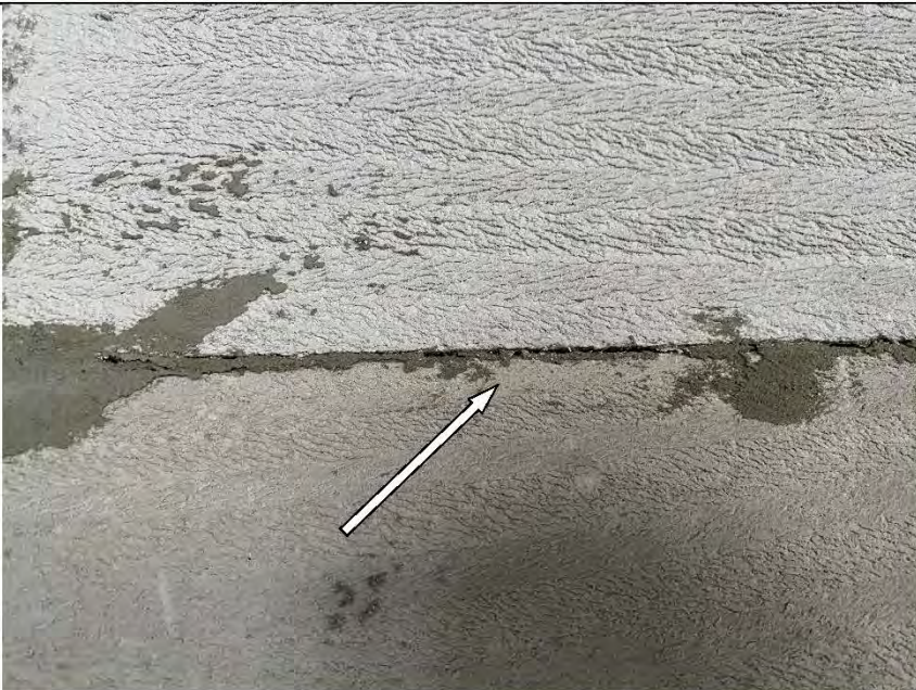
Фото №53. Дефект швов кладки стен в спальне.
