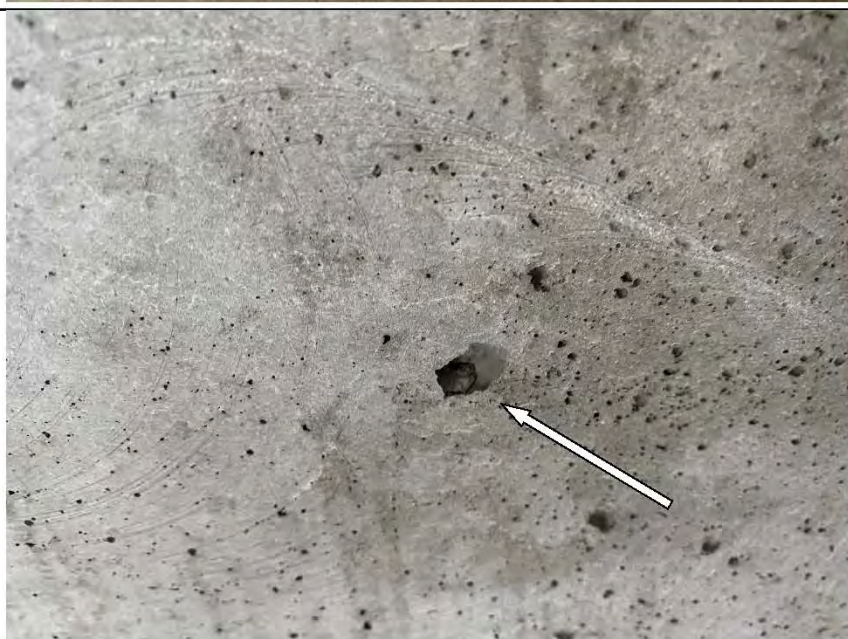
Фото №33. Железобетонные элементы конструкции имеют дефекты в гостиной.
