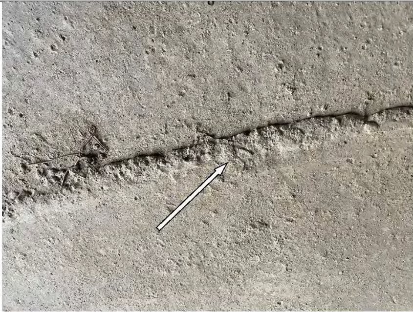
Фото №40. Железобетонные элементы конструкции имеют дефекты в гостиной.
