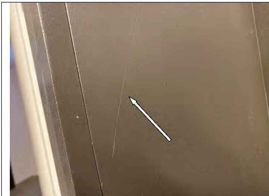
Фото №25. Дефекты (царапина) на доборном элементе входного дверного блока.
