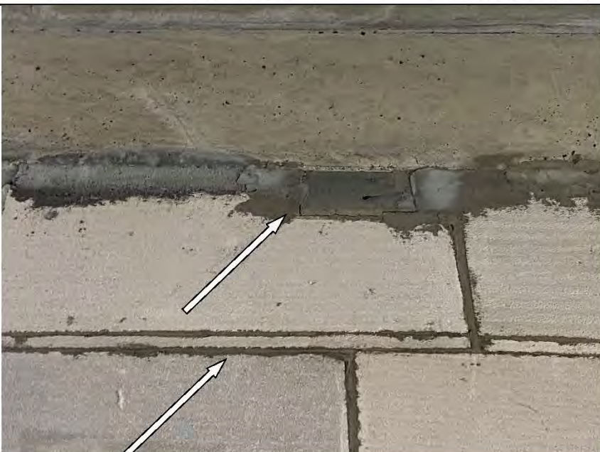
Фото №54. Дефект швов кладки стен в спальне.
