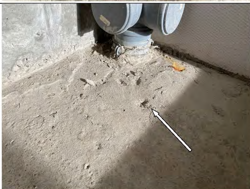
Фото №29. Железобетонные элементы конструкции имеют дефекты в санузле.
